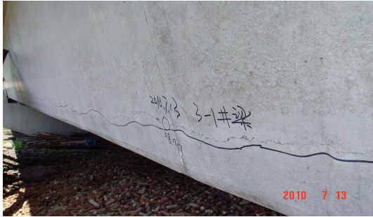
Fig.1 Box longitudinal crack
